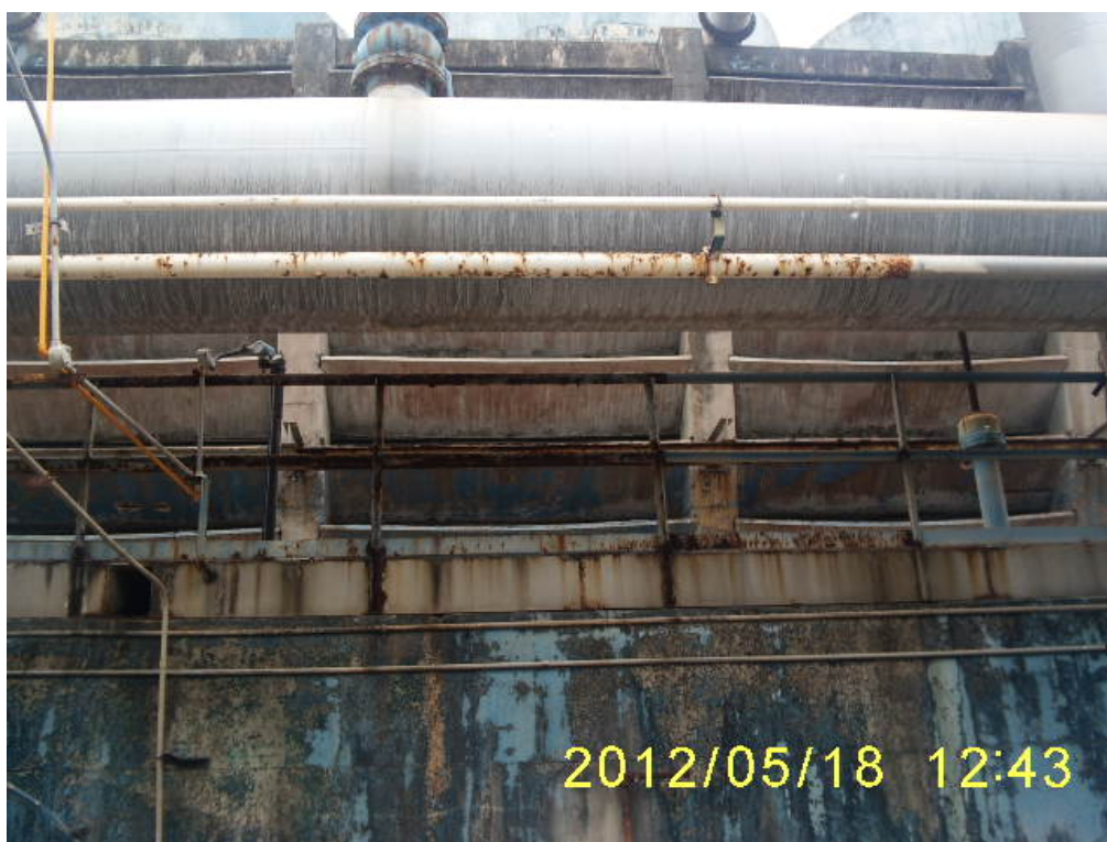
CABEZAL DE RETORNO DE AGUA DE ENFRIAMIENTO A LA TORRE DE LAS PLANTAS DE AMONIACO 4 Y 5
