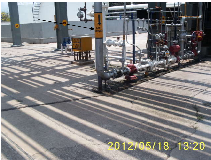
LINEA DE GAS NATURAL DE ALIMENTACION AL REFORMADOR PRIMARIO DE LA PLANTA DE AMONIACO N°7
