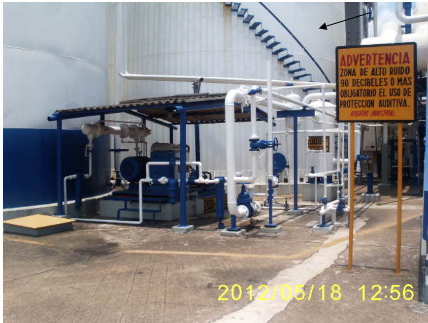
TANQUE DE ALMACENAMIENTO DE AGUA TRATADA DE LA PLANTA DE AMONIACO N°7
