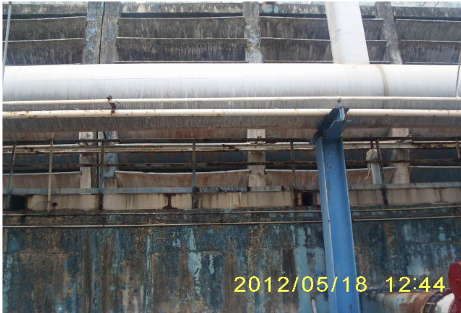
CABEZAL DE RETORNO DE AGUA DE ENFRIAMIENTO A LA TORRE DE LAS PLANTAS DE AMONIACO 4 Y 5
