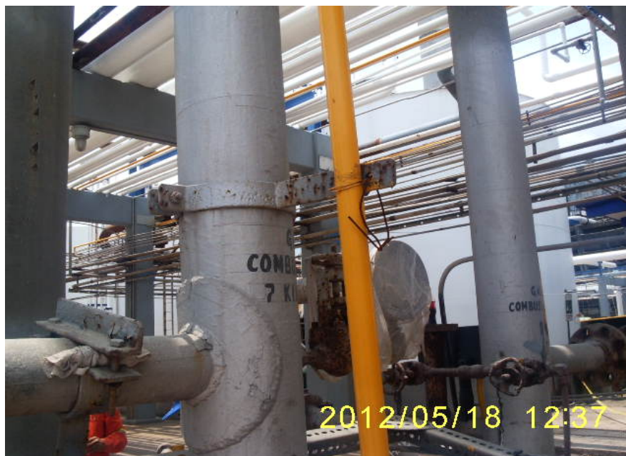
LINEA DE GAS COMBUSTIBLE A LA CALDERA PAQUETE DE LA PLANTA DE AMONIACO N°5
