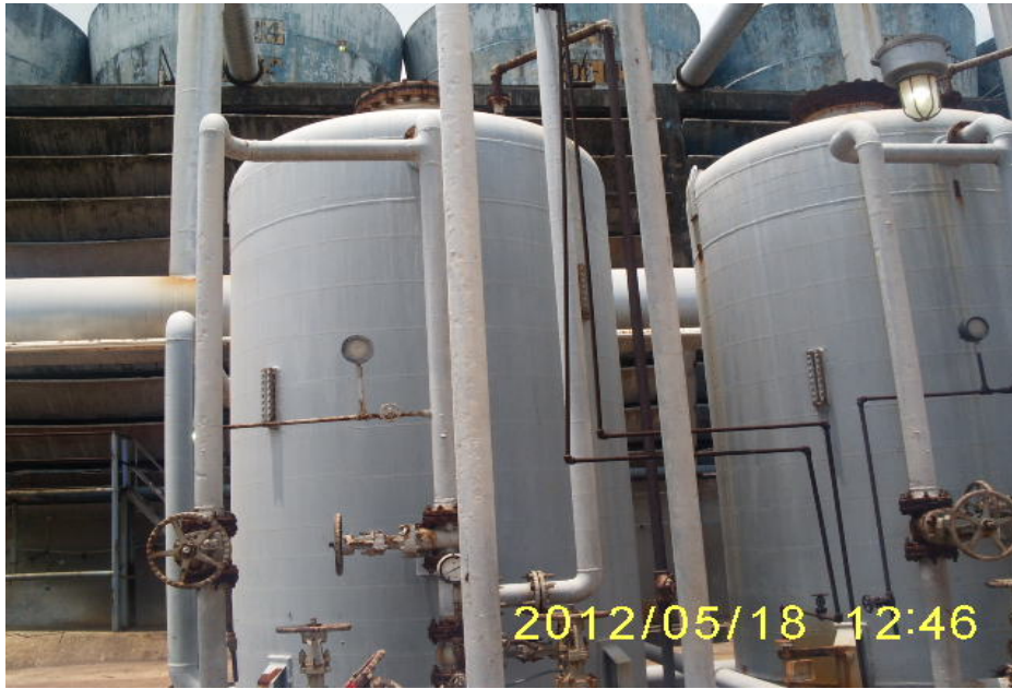
FILTROS DE ARENA DE LA LINEA DE SUCCION DE AGUA DE ENFRIAMIENTO DE LAS TORRES DE LA PLANTA DE AMONIACO 5
