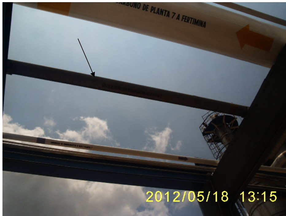
LINEA DE GAS NATURAL DE ALIMENTACION AL REFORMADOR PRIMARIO DE LA PLANTA DE AMONIACO N°7
