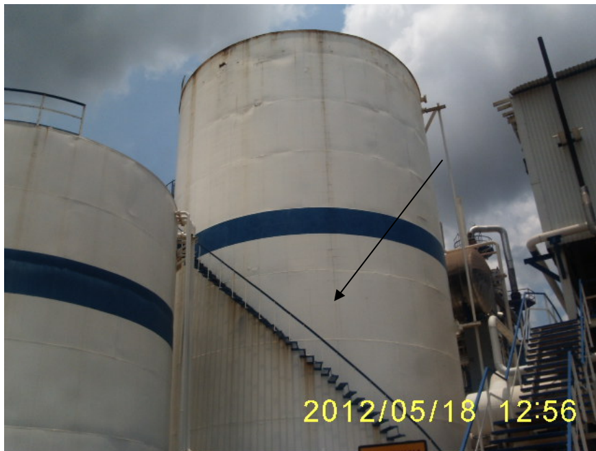
TANQUE DE ALMACENAMIENTO DE AGUA TRATADA DE LA PLANTA DE AMONIACO N°7
