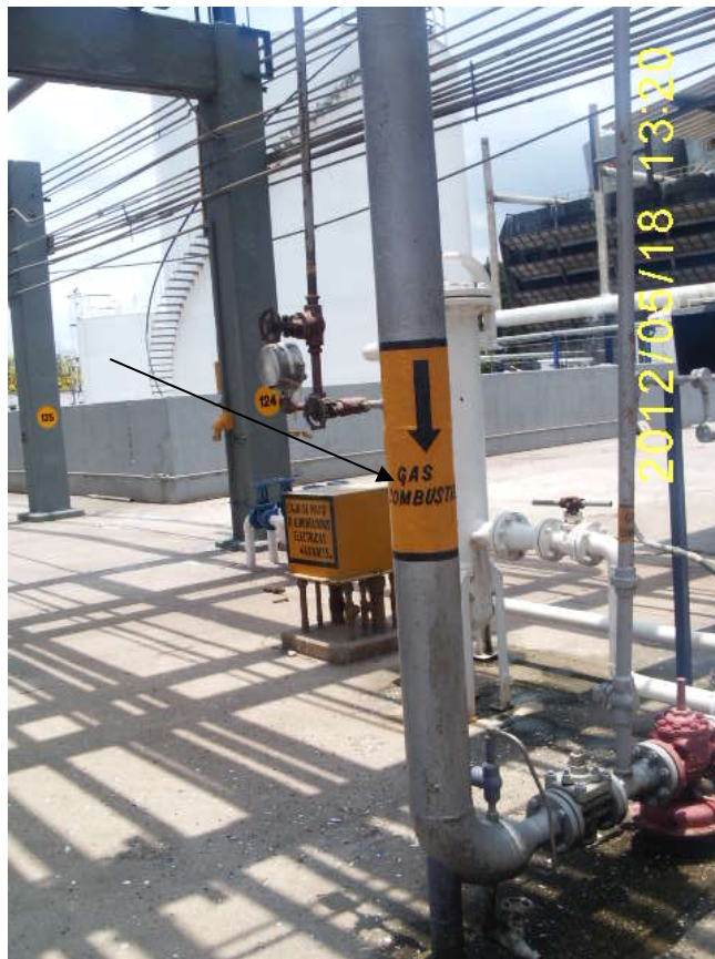
LINEA DE GAS NATURAL DE ALIMENTACION AL REFORMADOR PRIMARIO DE LA PLANTA DE AMONIACO N°7
