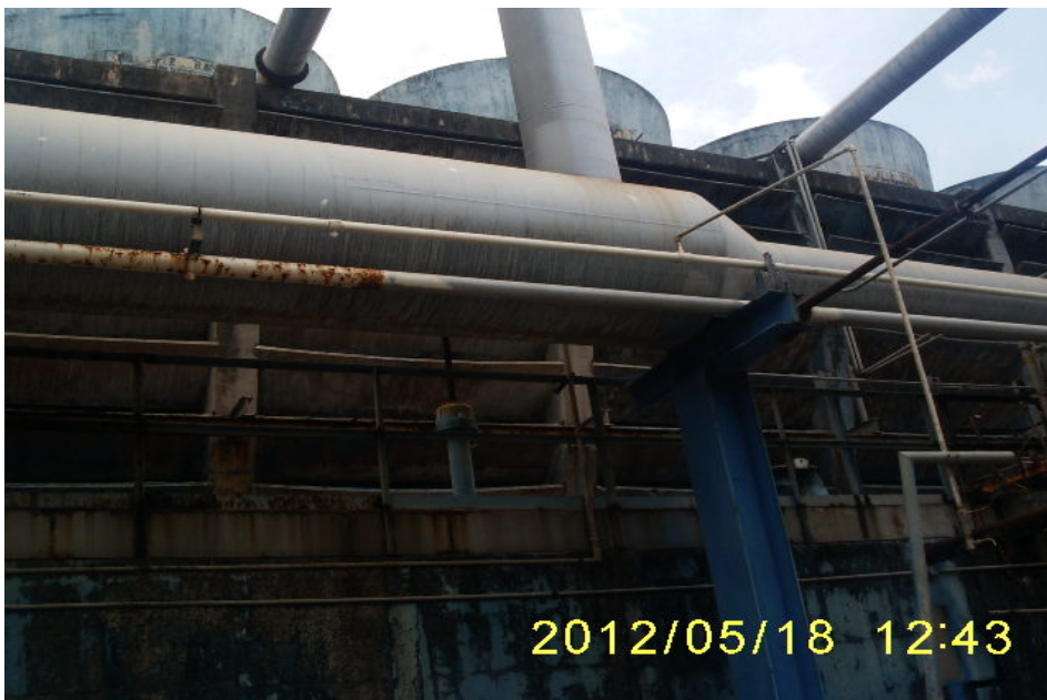
CABEZAL DE RETORNO DE AGUA DE ENFRIAMIENTO A LA TORRE DE LAS PLANTAS DE AMONIACO 4 Y 5
