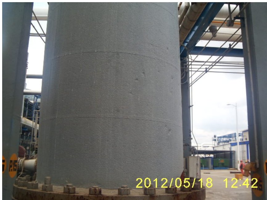
LINEA DE 36" DE AGUA DE ENFRIAMIENTO SUCCION DE LA TORRE DE ENFRIAMIENTO DE LAS PLANTAS DE AMONIACO 4 Y 5
