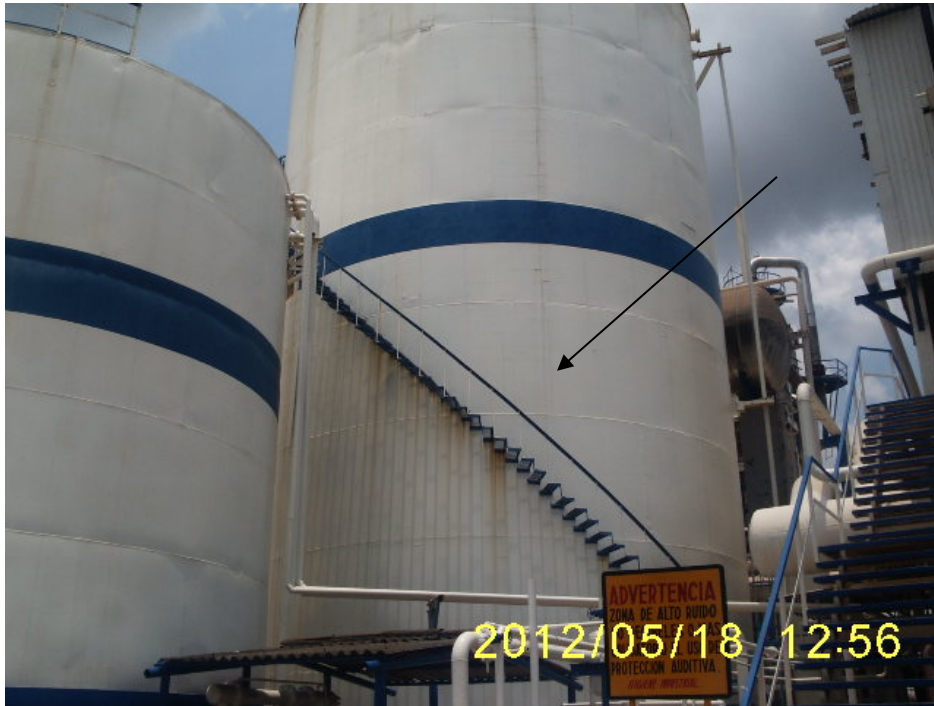
TANQUE DE ALMACENAMIENTO DE AGUA TRATADA DE LA PLANTA DE AMONIACO N°7
